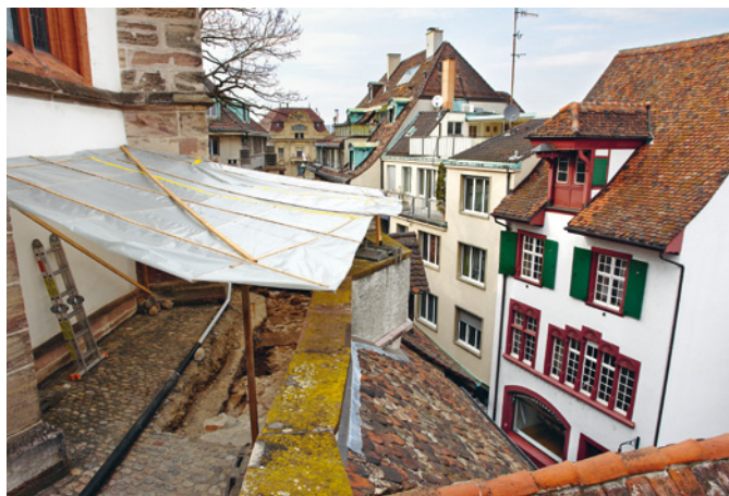
Abb. 12 Blick auf die Stützmauer mit dem Erker zwischen der Martinskirche und den Häusern am Rheinsprung. Unter der Zeltplane liegt die Ausgrabungsfläche. Foto: Christian Stegmüller.
