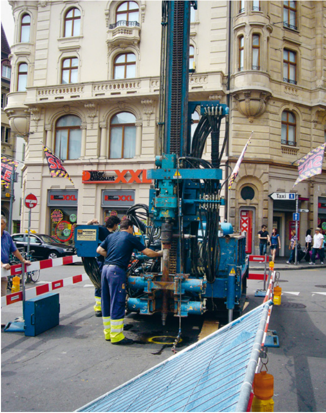
Abb. 45 Das Amt für Umwelt und Energie setzt am Basler Umwelttag zur Grundwasserbohrung an. Foto: Christoph Matt.
