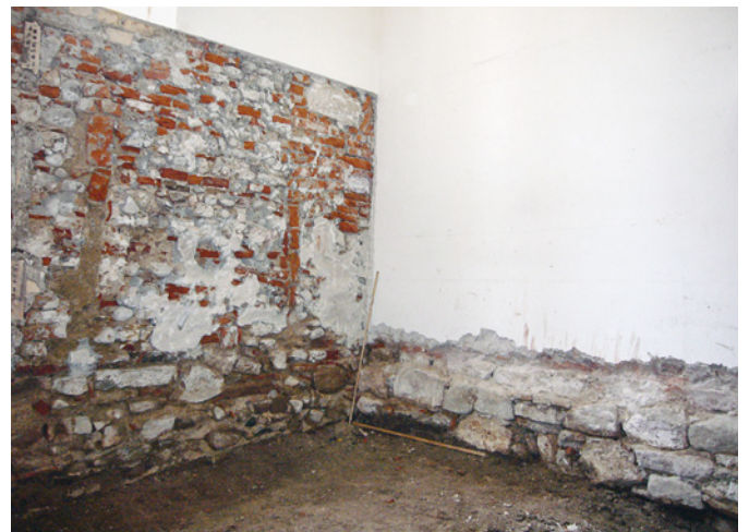
Abb. 37 Westlicher Seitenflügel: Blick auf die stark gestörte Mauer mit vielen Backsteinvormauerungen neben der Zufahrt (links), rechts die junge Zwischenmauer. Foto: Christoph Matt.
