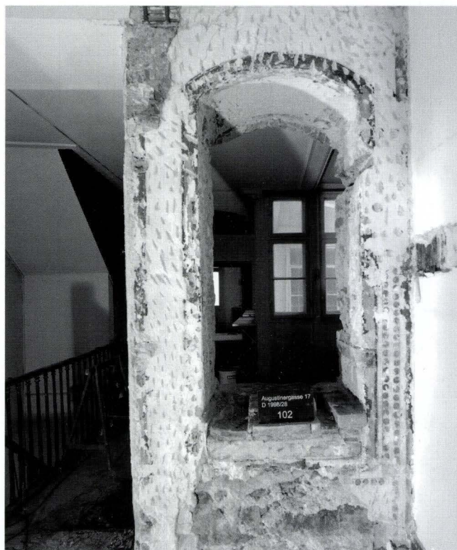
Abb. 18 Vorderhaus, Hoffassade 1. OG, innen. Die Fensteröffnung aus der Bauzeit (um 1360) wurde nachträglich verschmälert, die rechte Leibung blieb mit dem Bollenstabdekor, der auch die anstossende Wand begleitet, erhalten. Der Stichbogen wurde tiefer gesetzt. Die Änderung entstand im Zusammenhang mit dem Einbruch des linken Durchgangs zum Hofflügel. – Foto: Basler Denkmalpflege.
