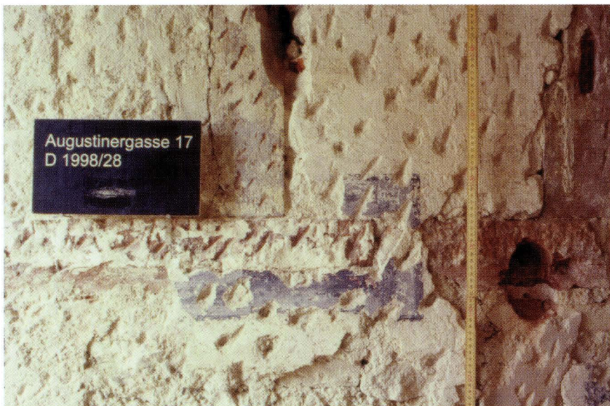
Abb. 20 Vorderhaus, Hoffassade 2. OG, rechte Hälfte: Reste des Gurtgesimes unter orig. (vermauertem) Fenster. Das in einem ersten Schritt von rechts verkürzte Gesims wurde mit grauem Begleitband umfasst. Darauf stehen die Fensterstöcke mit dem schaufelartigen Kehlauslauf. – Foto: Basler Denkmalpflege.
