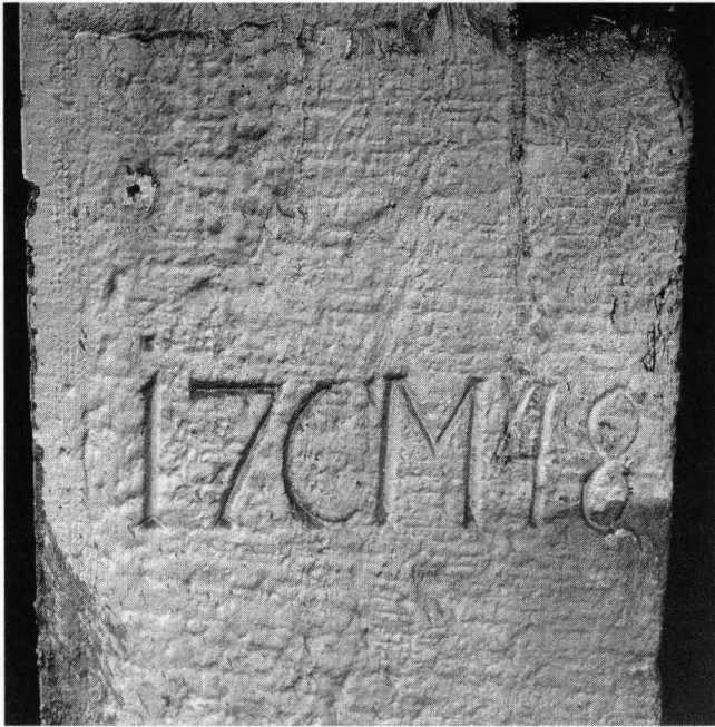
Abb. 12. Inschrift mit Jahrzahl auf Pfeiler an der Rückseite von Haus 2 Nord (Erdgeschoss). – Foto: BaDpf. B 501/21.
