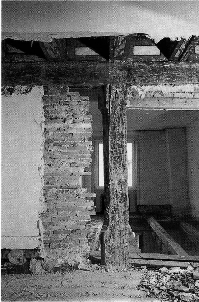
Abb. 12 Bäumleingasse 14. Freigelegte Stütze des Ausbaus von 1498 im 3. Obergeschoss. Bemalung der Decke aus dem 17. Jahrhundert. – Foto: BaDpfl B 764–10.
